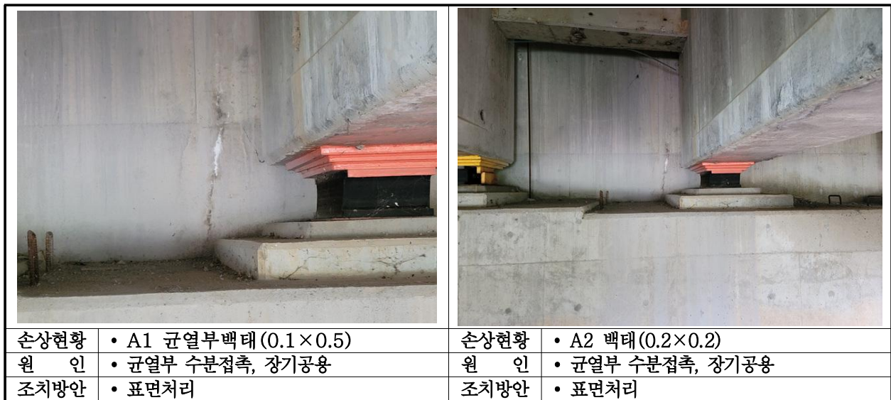
【사진 25.3.9】 교대 손상현황
